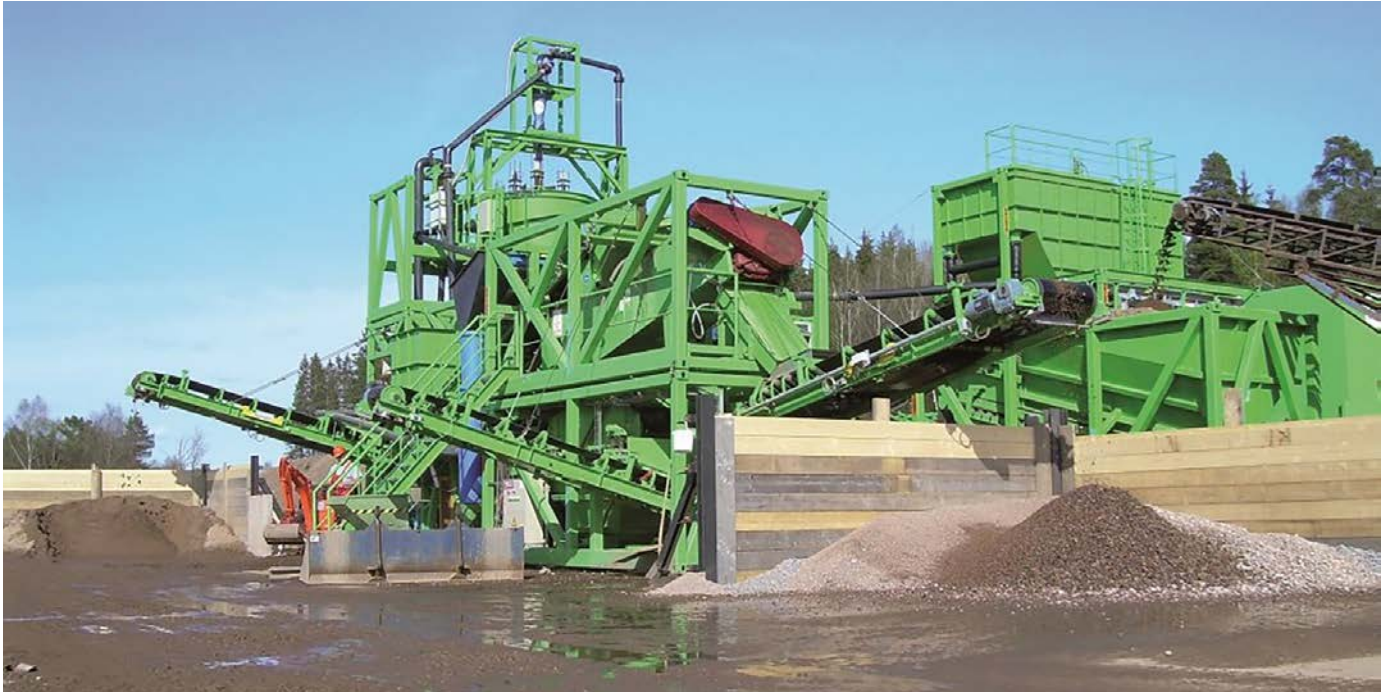
De grondwasinstallatie is in staat PFAS onschadelijk te maken.
